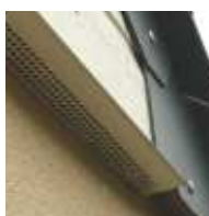
4a. Larmier ventilé : assure en plus la ventilation au niveau du linteau.
